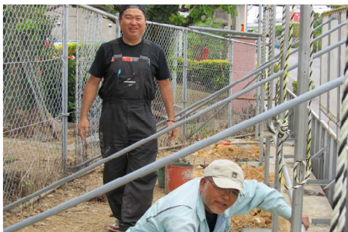
4月21日(木) (警察署前へ「こいのぼり掲揚ポール」の設置作業を行うクラブ三役。)
